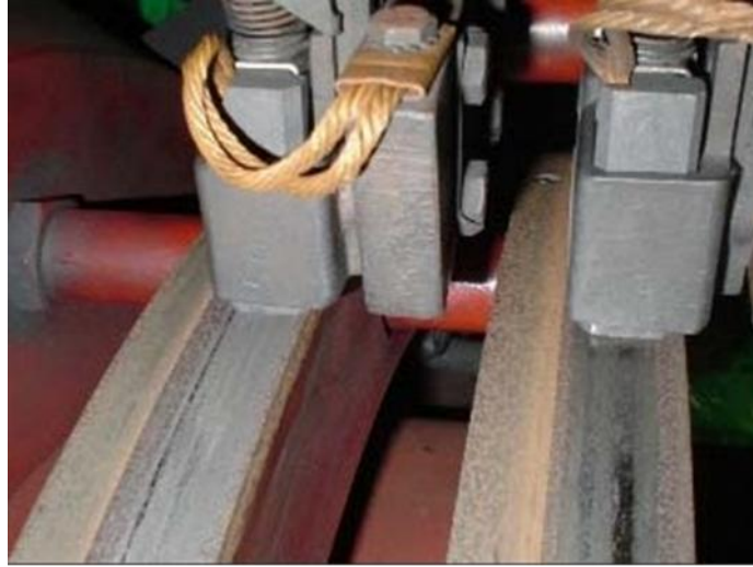
Figura 49. Corrosión en anillos deslizantes.
