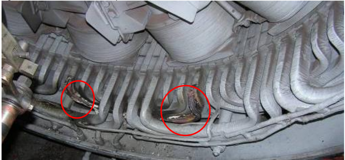
Figura 67. Cortocircuito entre espiras del estátor
