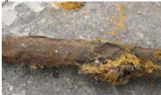
Figura 89. Corrosión en conductores subterráneos.
