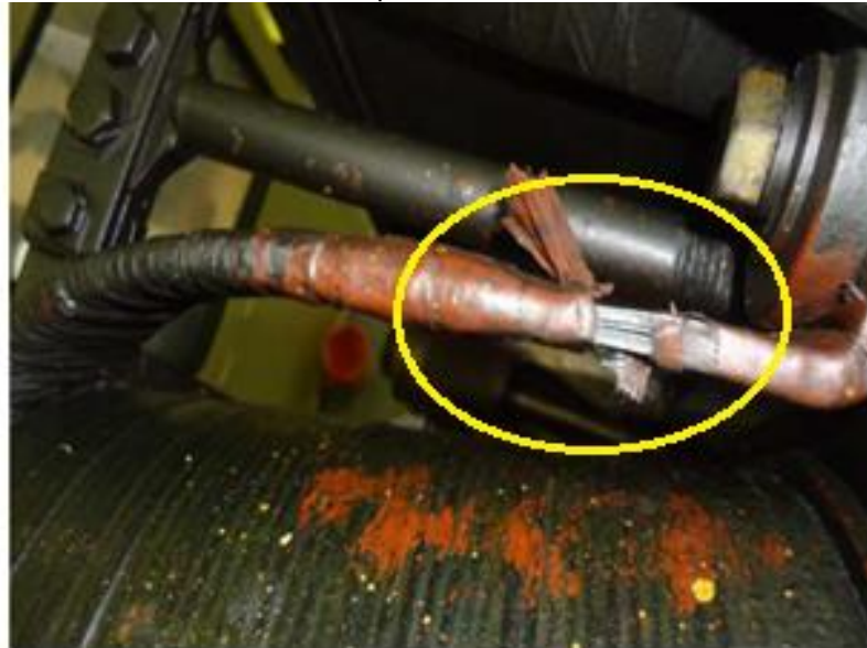
Figura 58. Deterioro del material aislante un puente del rotor.
