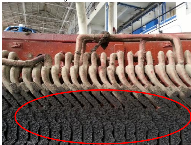
Figura 61. Contaminación del estátor del generador
