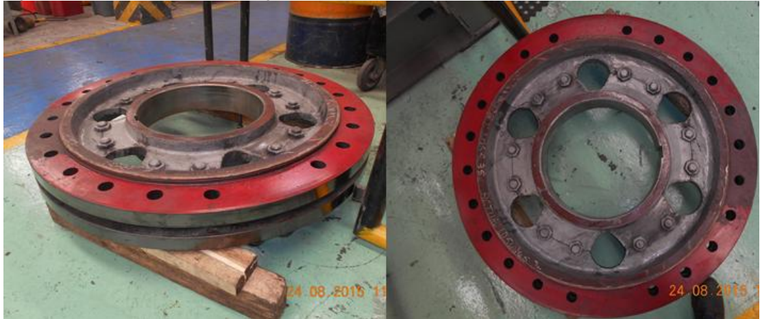
Figura 18. Anillos deslizantes de generador hidroelétrico de 28,8 MVA.
