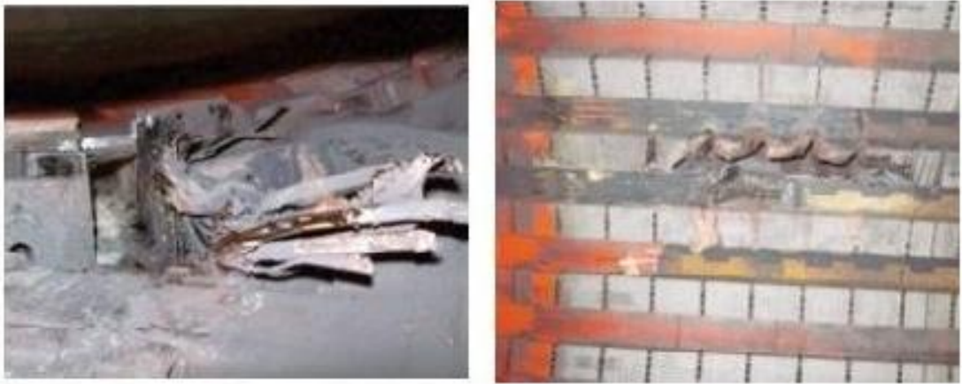
Figura 70. Falla entre fase a tierra causada por la fractura del devanado
