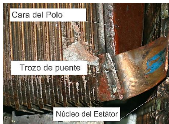
Figura 42. Falla en el puente del rotor.
