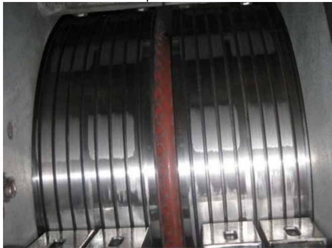
Figura 44. Imagen de escobilla sobre la superficie del anillo deslizante.
