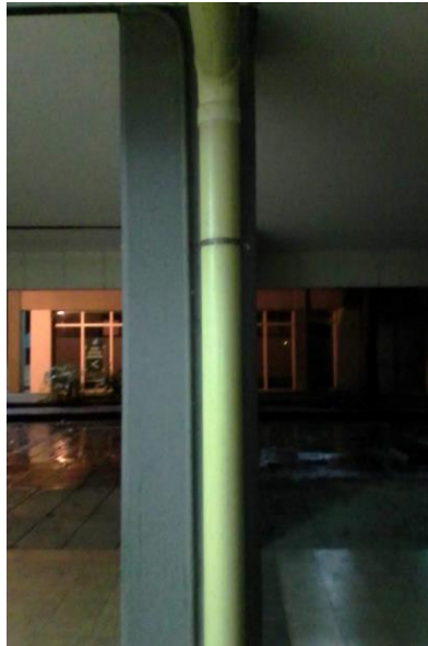
Figura 8.7. Material de bajantes edificio 320 (Facultad de Ciencias Naturales y exactas)
