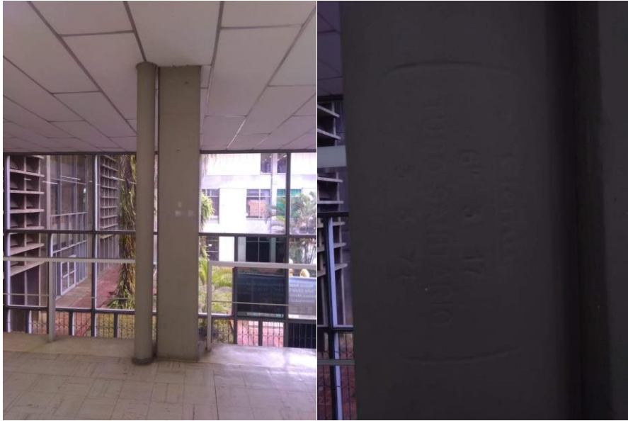
Figura 8.8. Material de bajantes edificio 318 (Biblioteca)
