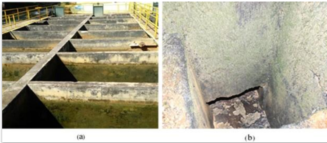
Figura 6. Floculadores de la PTAP El Arroyo (a) y Recámara de orientación de flujo (b)
