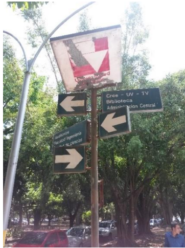
Fig. 52 Señales guía en mal estado
