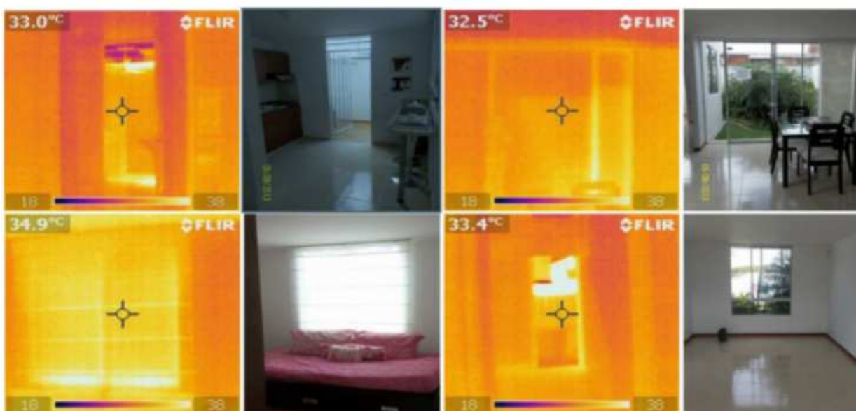
Ilustración 2. Imágenes térmicas del interior de una VIS construida con sistema industrializado en concreto, en donde se puede apreciar las ganancias de calor en la fachada. Fuente Barona (2016).
