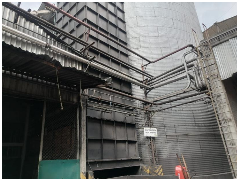
Figura 7. Conductos sin señalización
