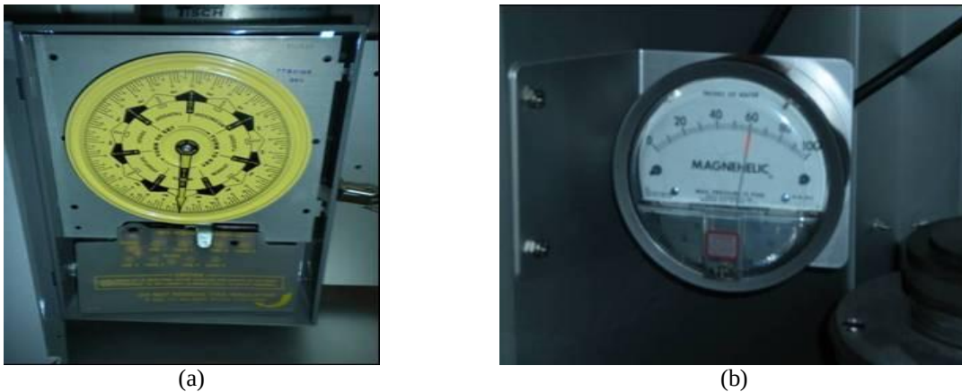
Figura 7.15 (a) Temporizador Foto 18. (b) Medidor Magnehelic a 60 pulgadas
