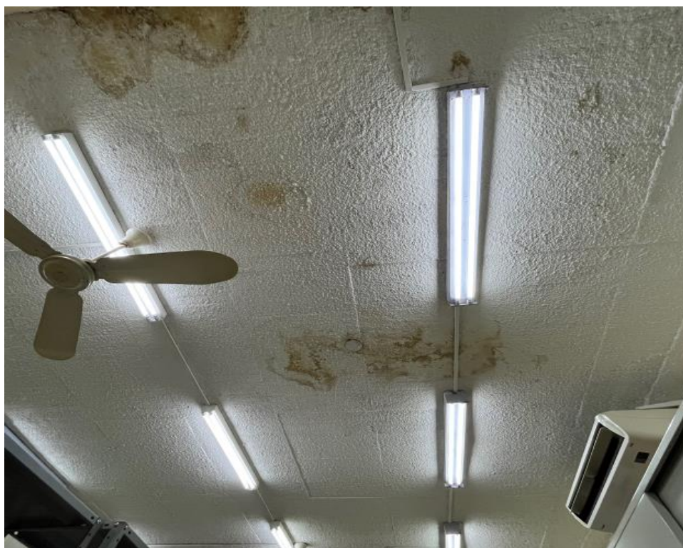
Ilustración 18. Humedad en el techo del archivo.
