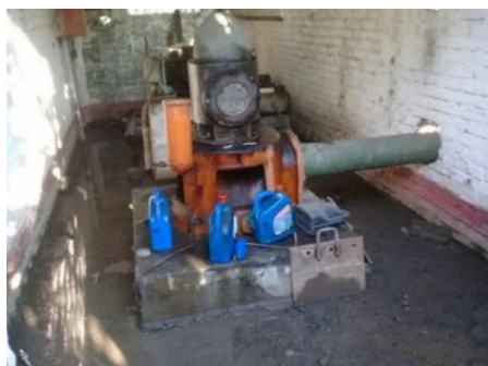
Fotografía 2. Componentes de equipo de bombeo.
