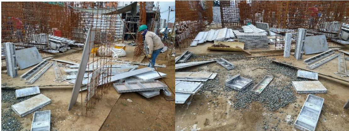
Figura 3.10. Desorden en la ubicación de materiales Fuente: Elaboración propia.
