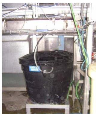
Foto 3. Tanque de almacenamiento agua del rinser
