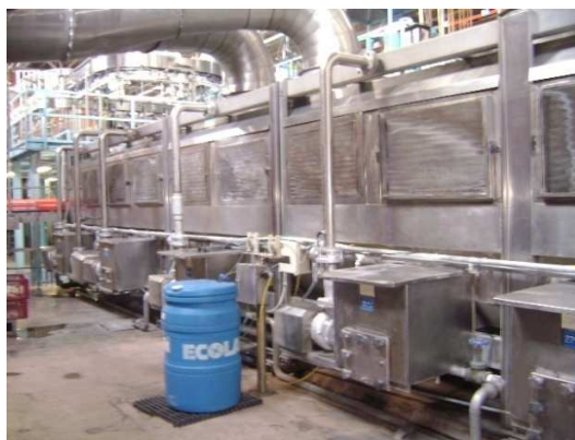
Foto 7. Túnel de enfriamiento – Cooler
