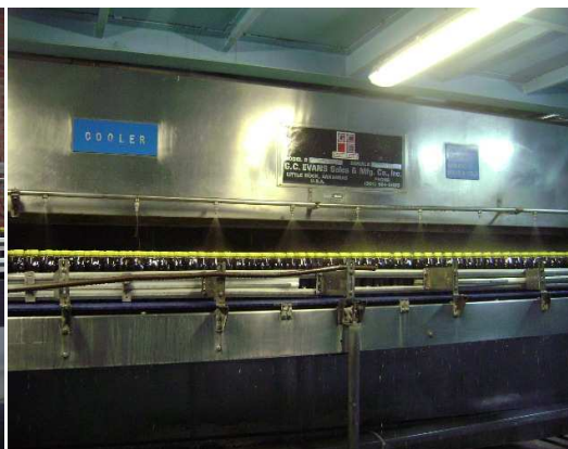
Foto 8. Duchas a la entrada del Cooler
