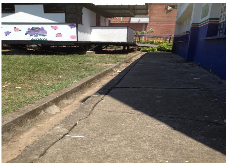
Figura 17. Canal de aguas lluvias Foto: Geovanny Moncayo
