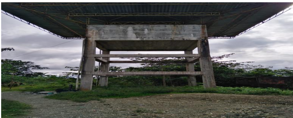
Figura 18 Tanque del acueducto
