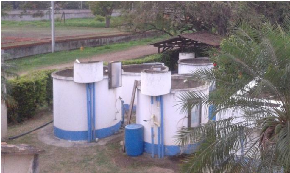
Figura 2. Unidad de filtración –FGAC
