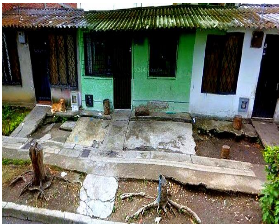
Fotografía 22. Barrio Caimitos. Se observa deterioro y desnivel de los andenes.
