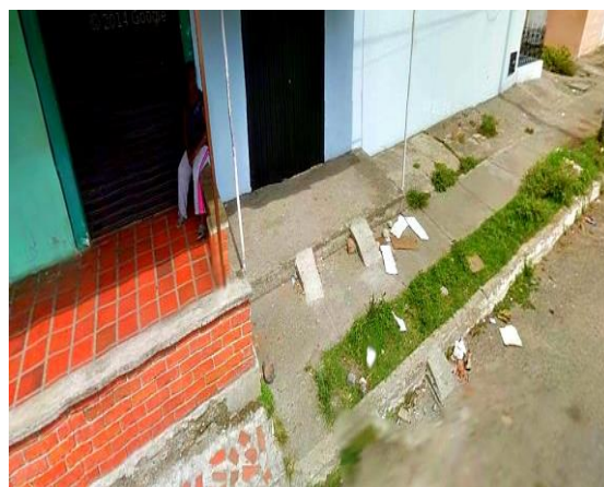
Fotografía 21. Andén del barrio Caimitos, que presenta problemas de deterioro y desniveles, además un muro obstaculizante.
