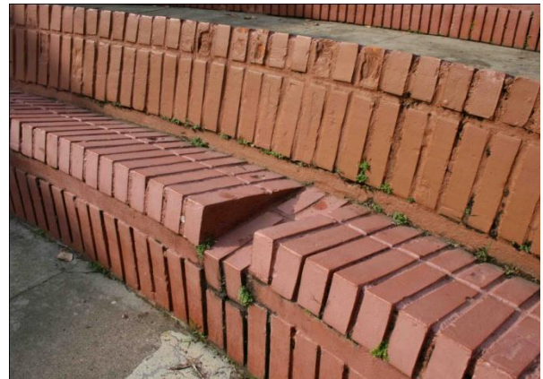
Vegetación asomándose entre el ladrillo y concreto de la plazoleta
