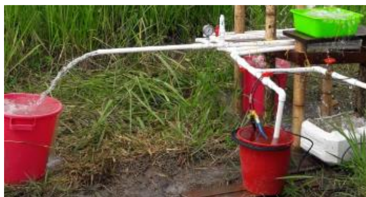
Figura 13. Instalación aireador Venturi
