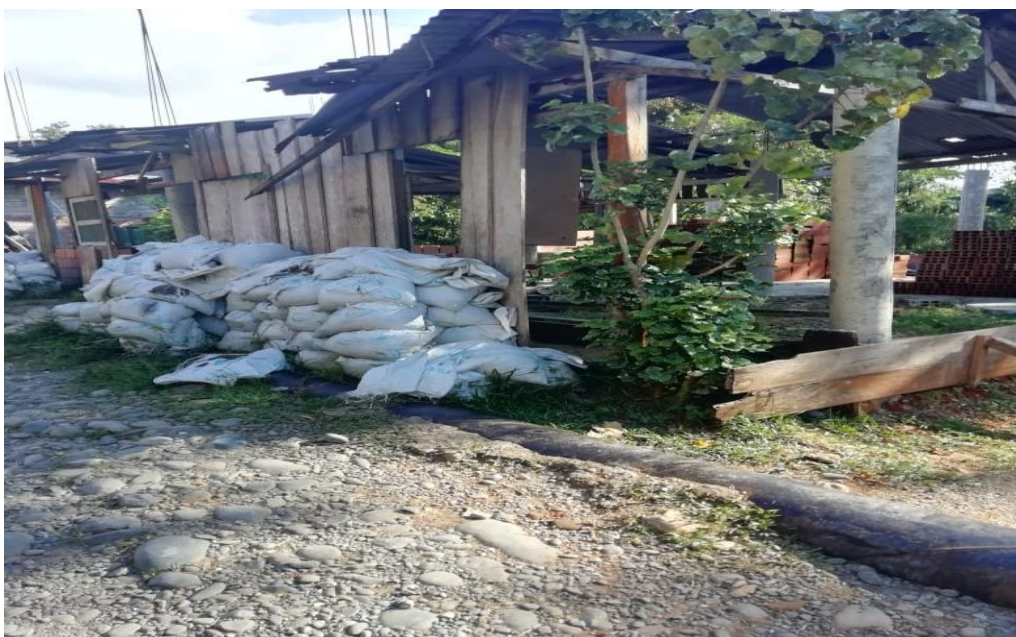
Obstrucción del paso y el ambiente que afecta al entorno
