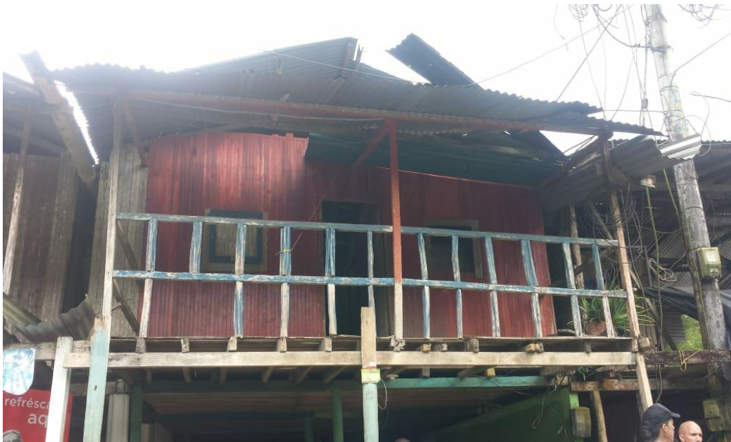
Esta fachada refleja el deterioro del tejado y la poca seguridad del establecimiento
