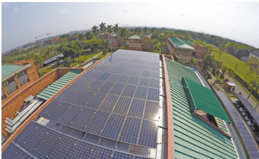
Figura 38. Sistema fotovoltaico de mayor potencia instalado en una institución educativa de Colombia (UAO). Fuente: Página web de la UAO
