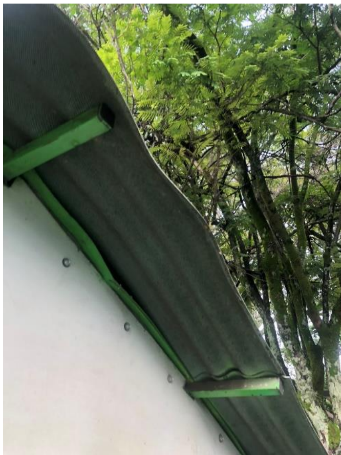
Ilustración 6: Deformación del techo, tomada durante la observación en campo. Fuente: fotografía de propia autoría (2025).
