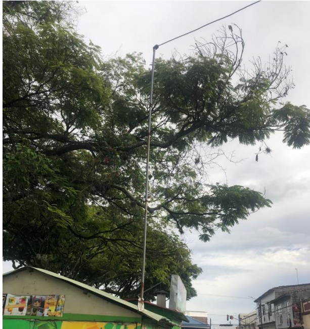
Ilustración 10: Suministro de energía eléctrica, tomada durante la observación en campo. Fuente: fotografía de propia autoría (2025).
