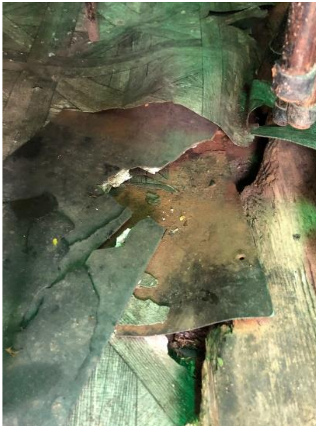
Ilustración 13: Deterioro del piso de madera, tomada durante la observación en campo. Fuente: fotografía de propia autoría (2025).
