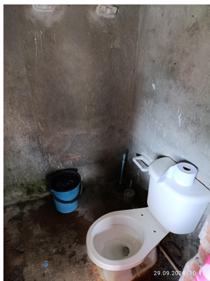
Figura 28. Sanitario de tanque. Foto: Autor.
