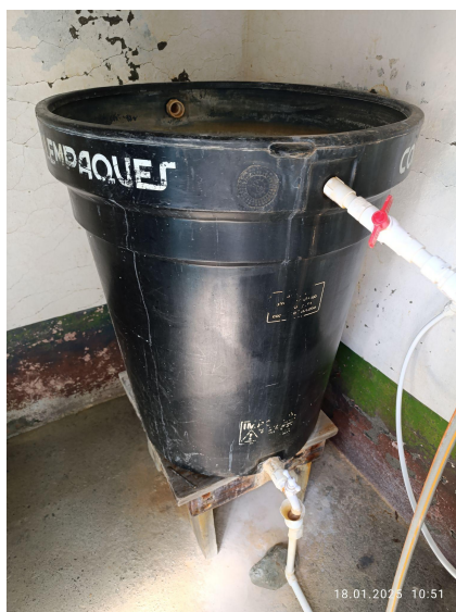
Figuras 20. Mecanismo de dosificación del agente desinfectante en el acueducto. Fuente: Autor.
