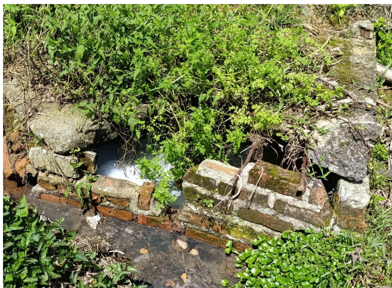
Figura 27. Tanque séptico actual. Foto: Autor.
