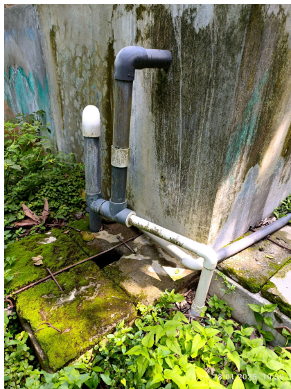
Figura 22. Tanque de almacenamiento del acueducto. Fuente: Autor.
