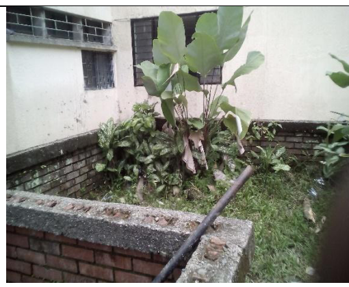
Imagen 6: Zona contigua al baño de mujeres- sin mantenimiento
