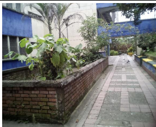
Imagen 7: Zona verde en mal estado, plantas deterioradas
