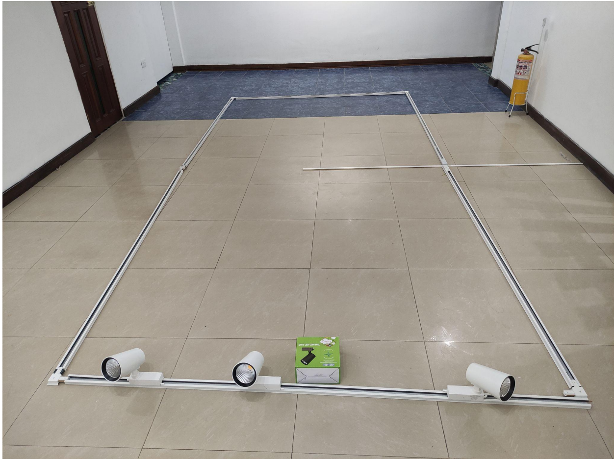
Fotografías del archivo personal de la planificación previa a la instalación del sistema de iluminación.
