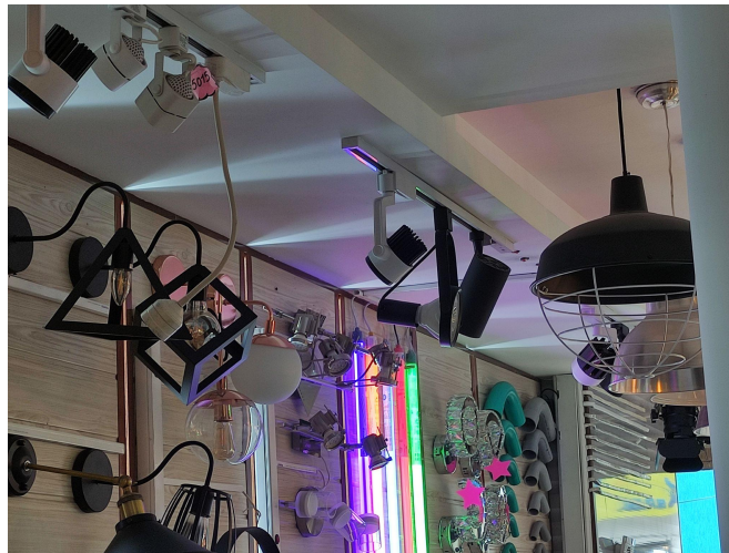
Fotografías del archivo personal de uno de los recorridos para la cotización del sistema de iluminación de la sala.
