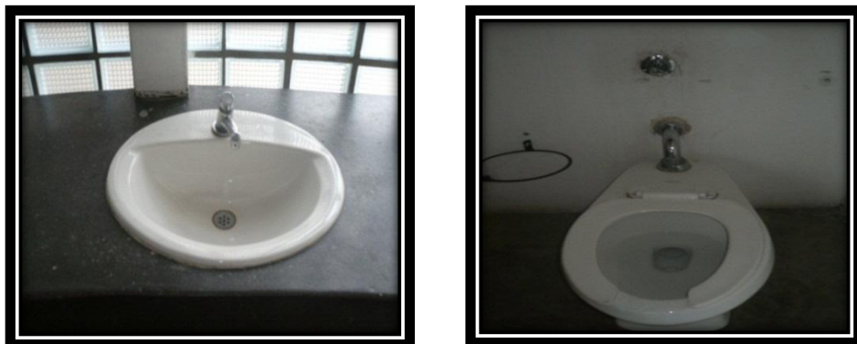
Fotografía 2. Sistema de ahorro de agua utilizado en el Estadio Pascual Guerrero
