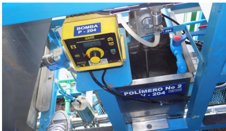
Anexo 10. Zona de dosificación de polímero para el tratamiento de lixiviado
