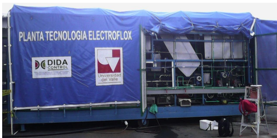
Figura 5. Planta Piloto de ELECTROFLOX® para tratamiento del lixiviado
