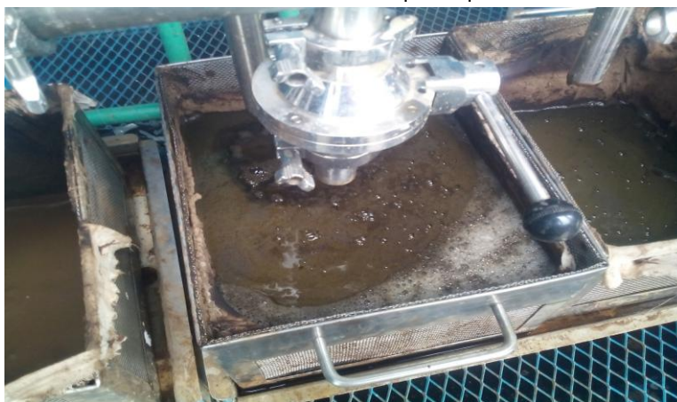
Anexo 2. Descarga de lodo de primer tanque sedimentador – ELECTROFLOX®
