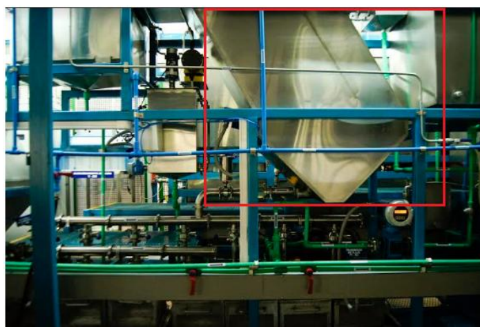
Figura 6. Zona de acumulación de lodos primer sedimentador (V-303)
