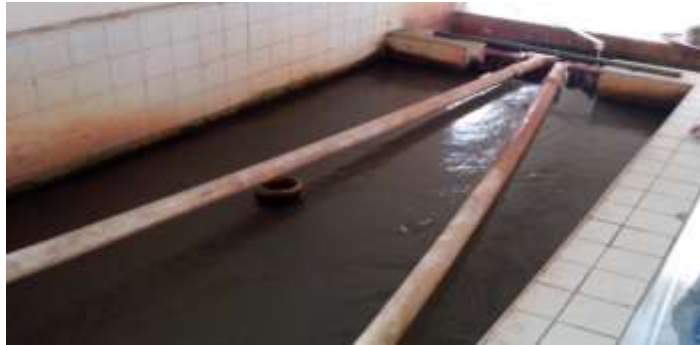
Fotografía 3. Cámara de Mezcla
