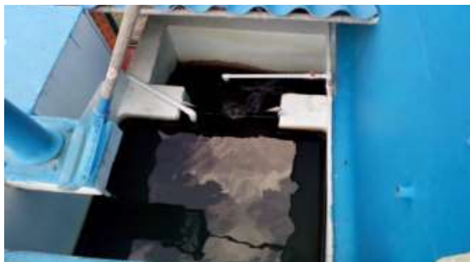
Fotografía 12. Canal de distribución de agua clorada
