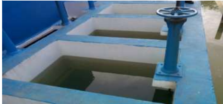
Fotografía 10. Canal y tanques de distribución para regular el paso del agua
