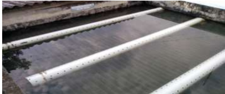
Fotografía 9. Sedimentador con filtro
