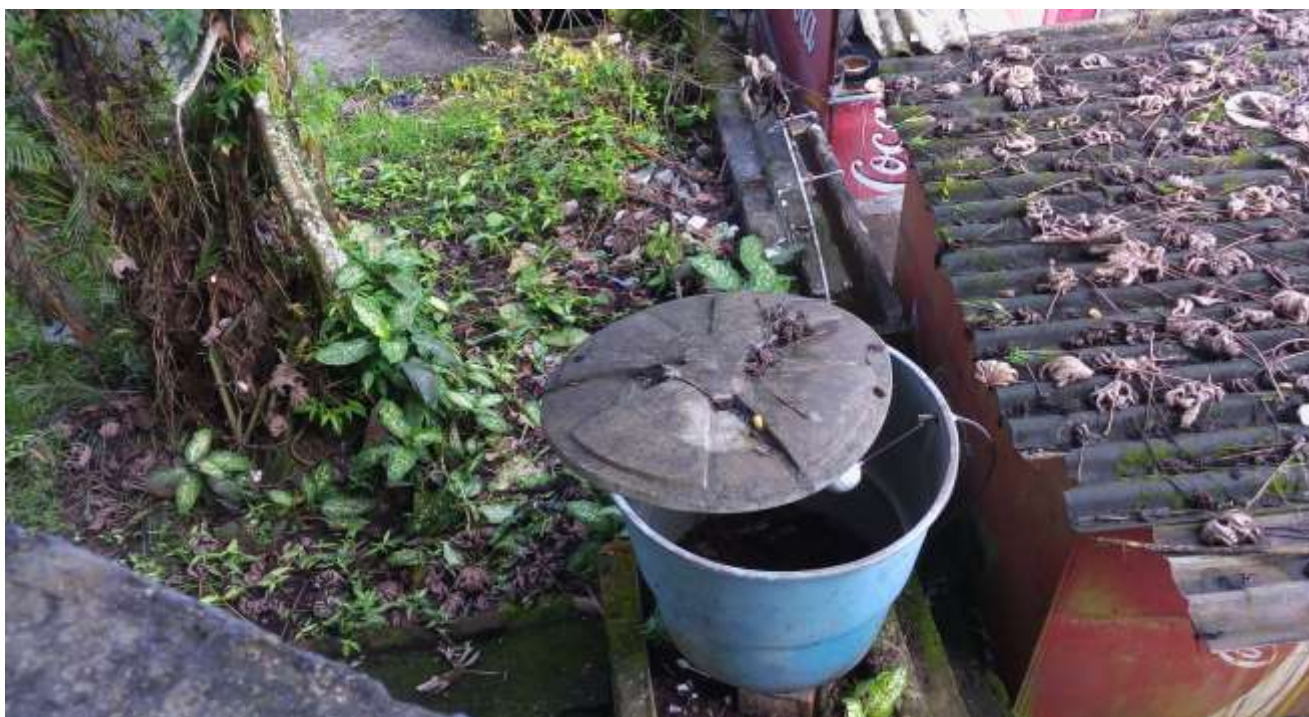
Foto tomada por equipo investigador. Tanque reserva de agua.
