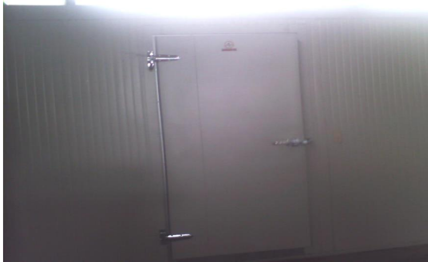
Figura 4. Cuartos fríos de congelación y refrigeración
