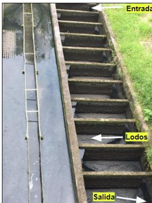
Figura 102. Presencia de lodos en el sistema de cloración
