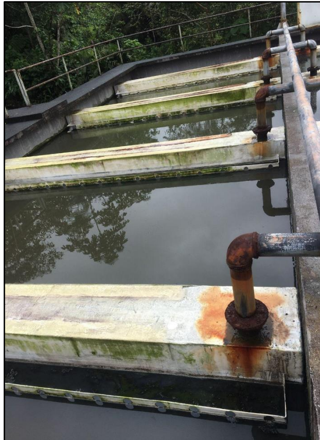
Figura 80. Parte superior de los reactores UASB
