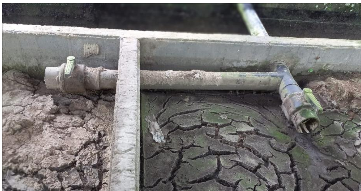
Figura 40. Tubería de distribución de la purga de lodos
