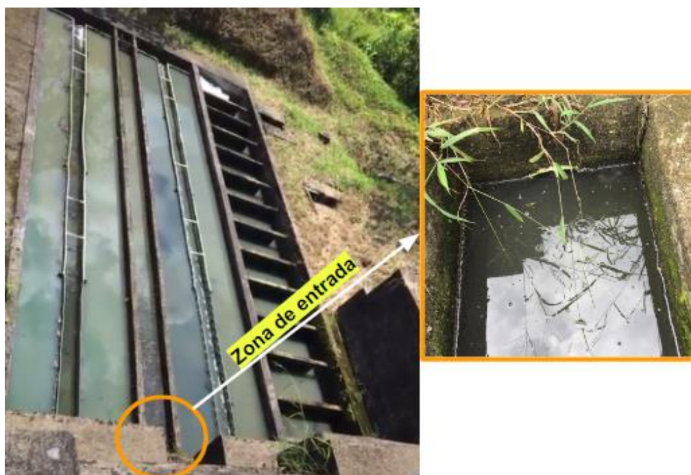
Figura 98. Entrada al sedimentador final
