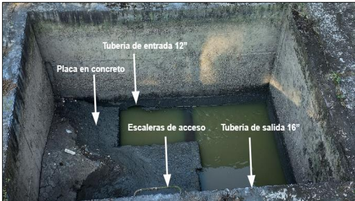
Figura 22. Estructura de la trampa de grasas
