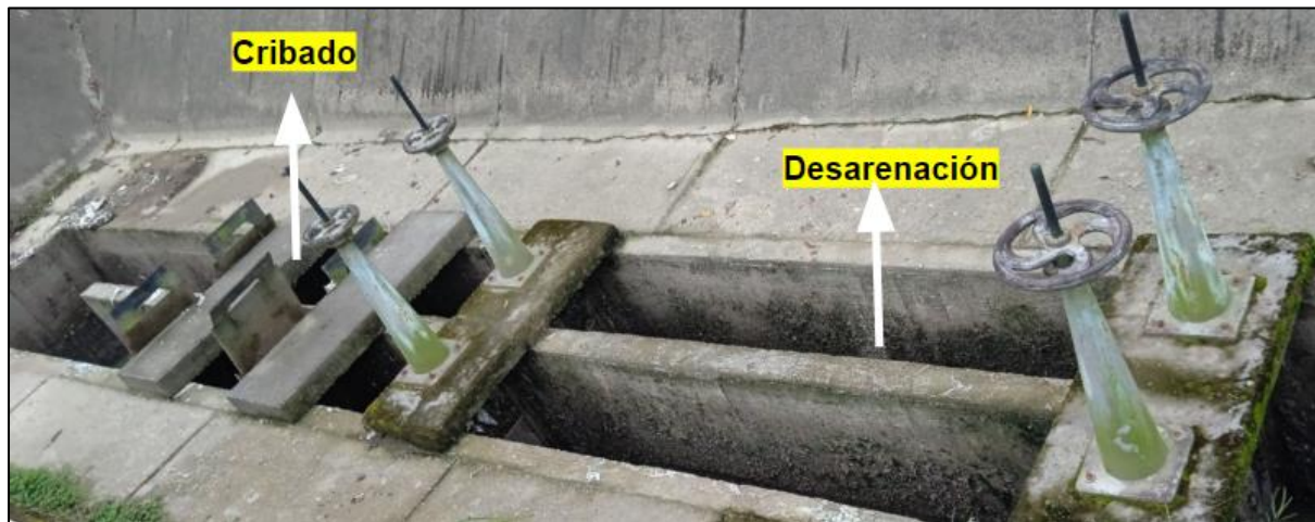
Figura 19. Líneas de cribado y desarenador
