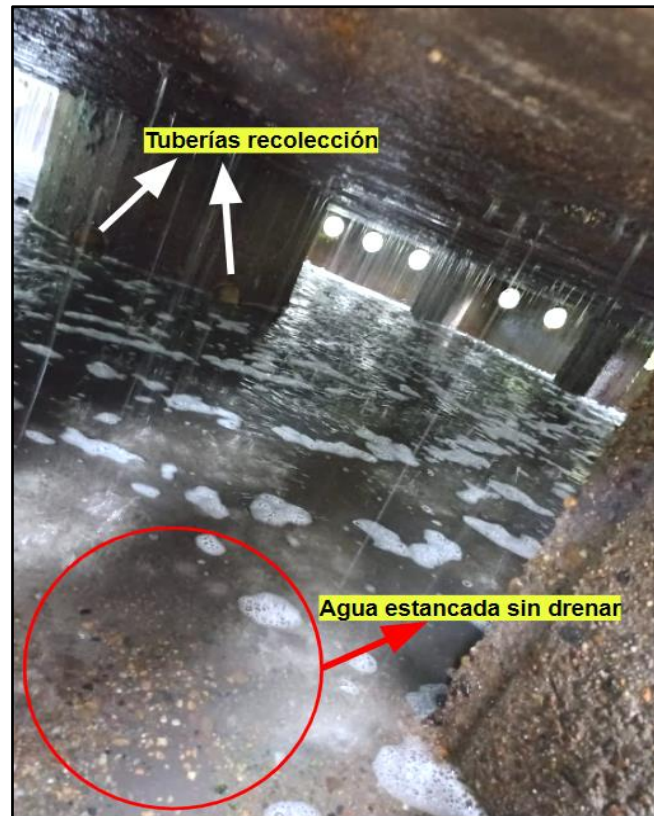
Figura 91. Acumulación de agua sin drenar en el piso del filtro percolador
