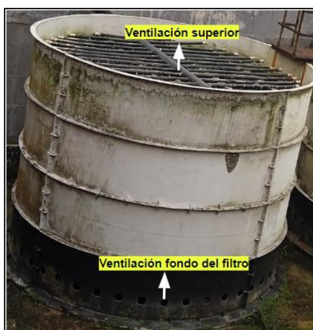
Figura 88. Ventilación natural del filtro percolador
