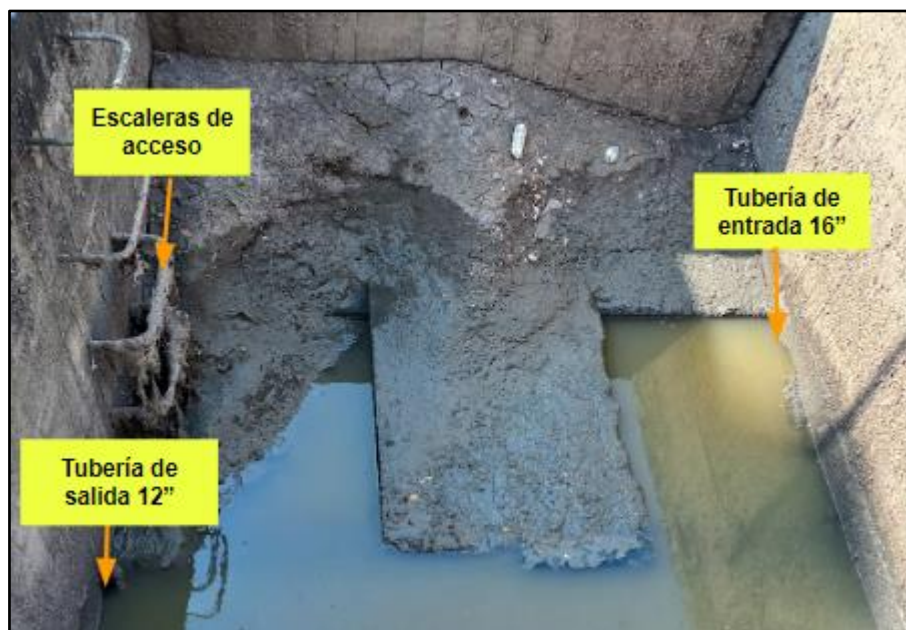
Figura 66. Estructura de la trampa de grasas
