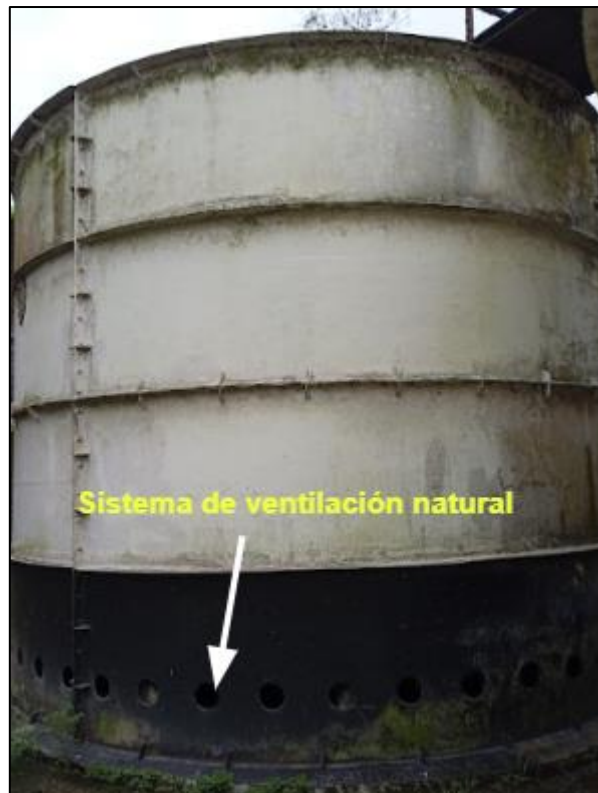
Figura 35. Sistema de ventilación
