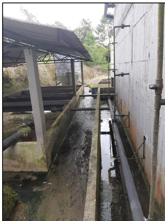
Figura 81. Tuberías de purga de lodos
