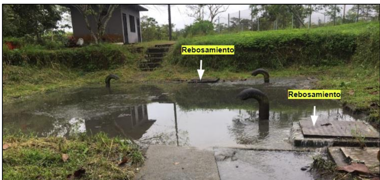
Figura 69. Rebosamiento del tanque homogeneizador
