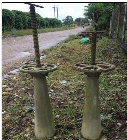
Figura 45. Válvulas estructura de entrada
