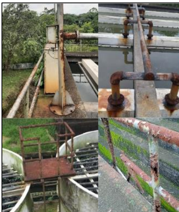
Figura 79. Corrosión generada por los gases del Reactor UASB
