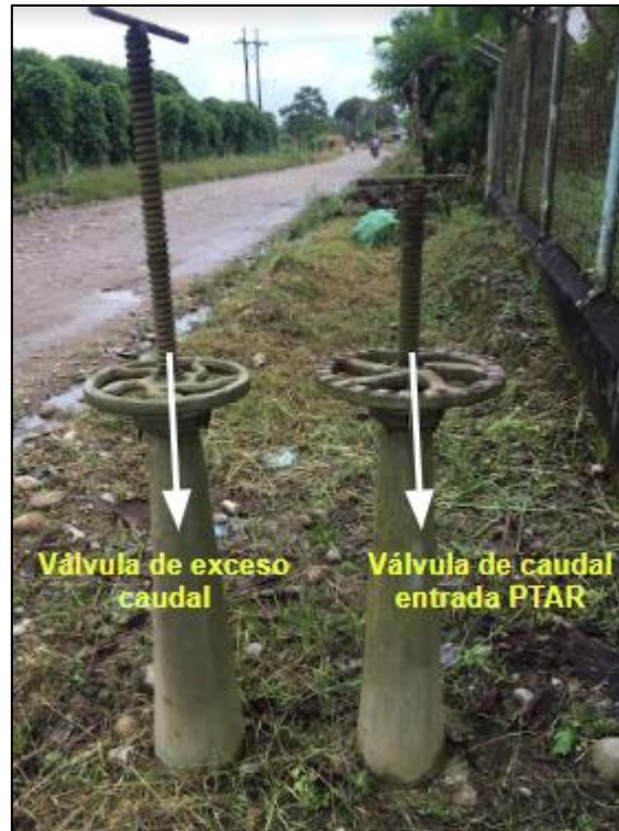
Figura 13. Válvulas de la estructura de entrada
