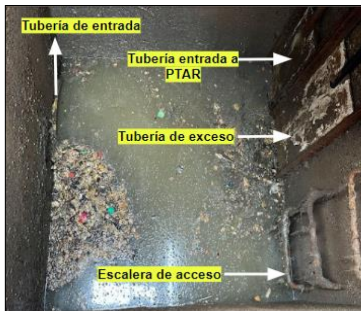
Figura 14. Tuberías de entrada y salida de la estructura
