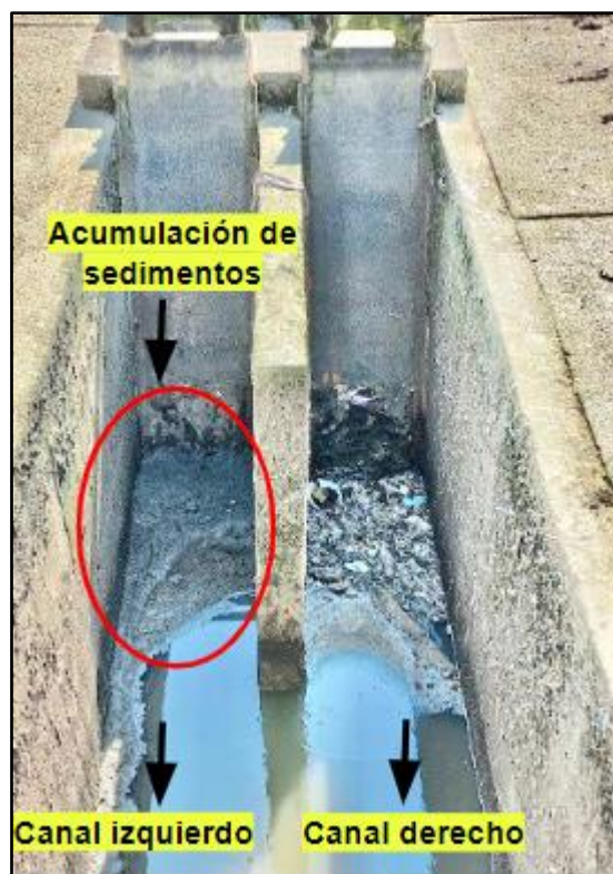
Figura 56. Distribución ineficiente del caudal en las líneas de tratamiento
