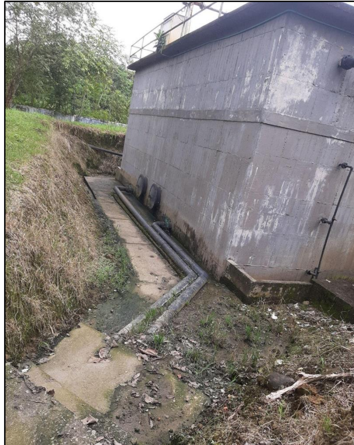
Figura 75. Tuberías principales de alimentación a los reactores UASB
