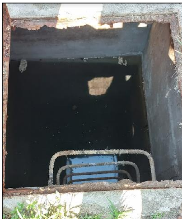
Figura 60. Cámara del desarenador
