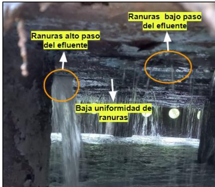
Figura 89. Placas del filtro percolador
