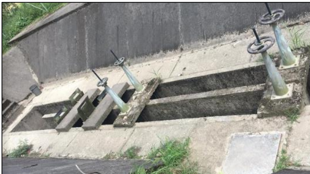
Figura 59. Línea de cribado y desarenador
