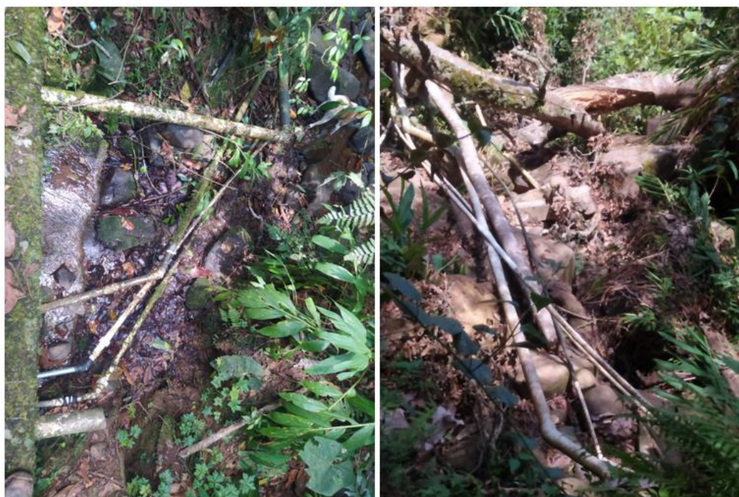
Figura 8 Tuberías de distribución, bocatoma los Arrieros.
