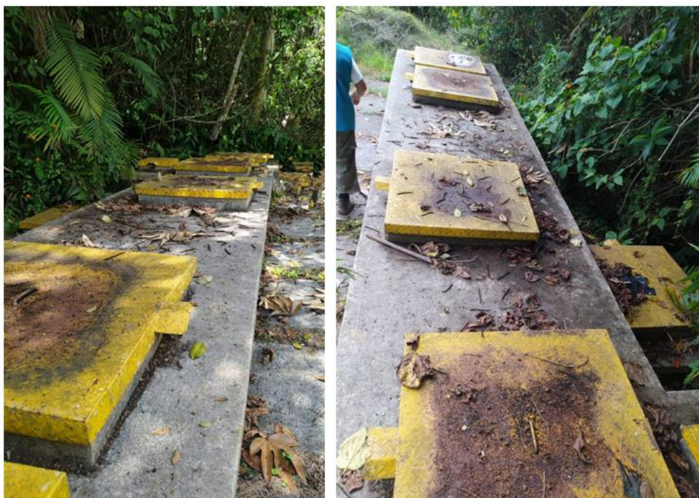
Figura 5 Desarenador bocatoma el Líbano
