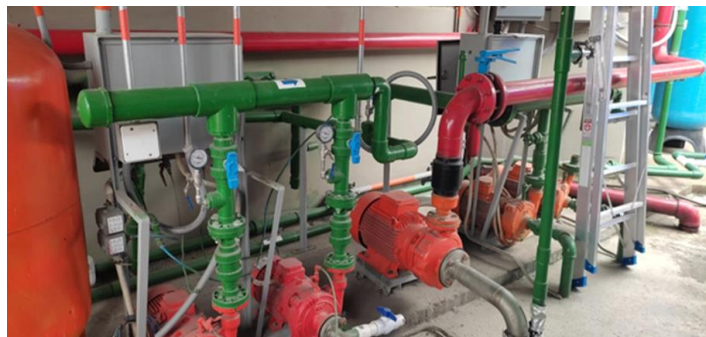
Figura 8: Sistema de presión de agua tratada.
