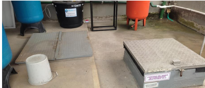
Figura 9: Compuertas de Tanques de Almacenamiento.
