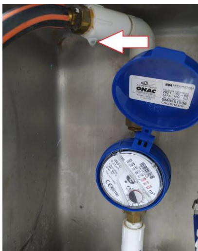
Figura 22: Fugas en puntos hidráulicos
