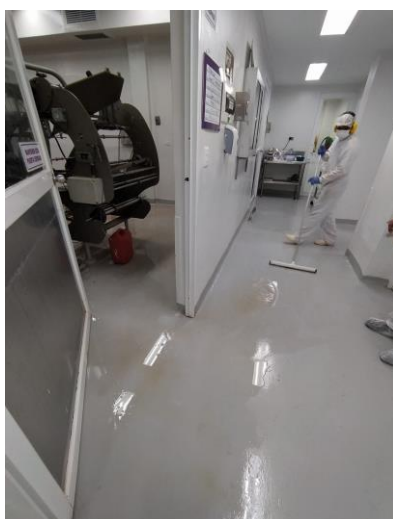
Figura 23: Dificultades en el drenaje (desniveles inadecuados)
