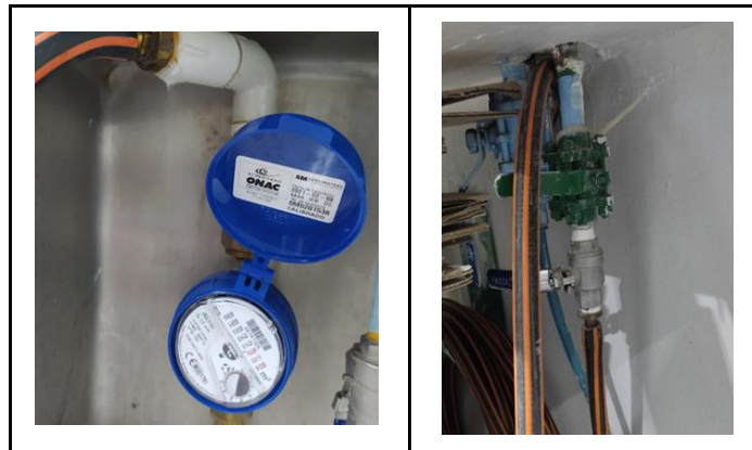
Figura 10: Micro medidores y punto de conexión de Mangueras.
