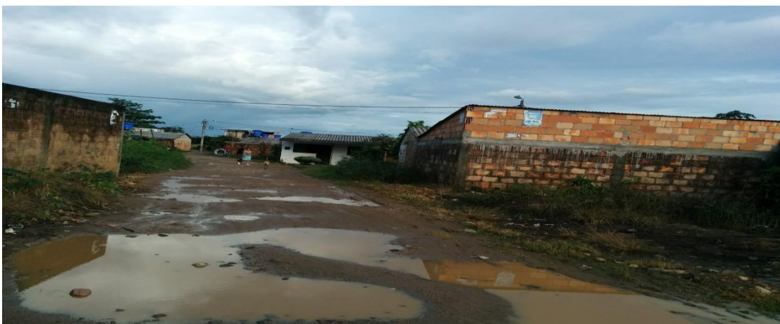
Figura 6 Calles en mal estado en La Gloria etapa I – Vías destapadas en la Etapa I
