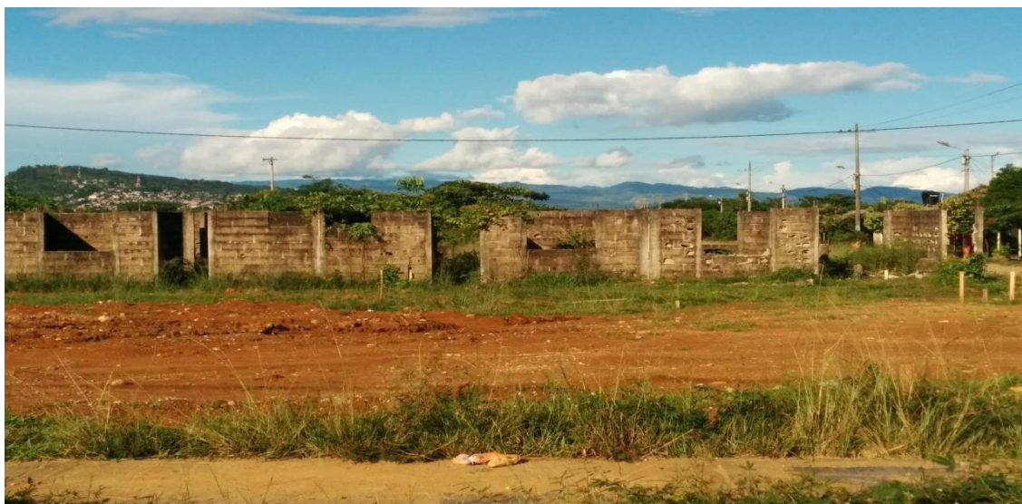
Figura 8 Viviendas sin concluir La Gloria etapa III - Viviendas inconclusas de la Etapa III.
