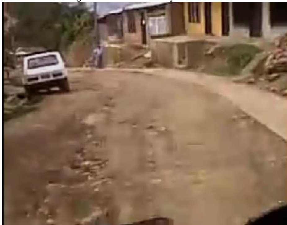
Figura 24. Carrera 69 sin pavimentar *.
