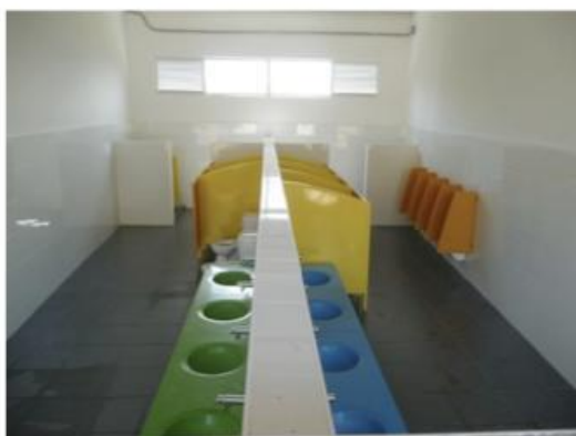
BATERIA DE BAÑOS
