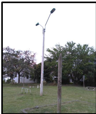
Figura 153. Luminaria. Elaboración propia
