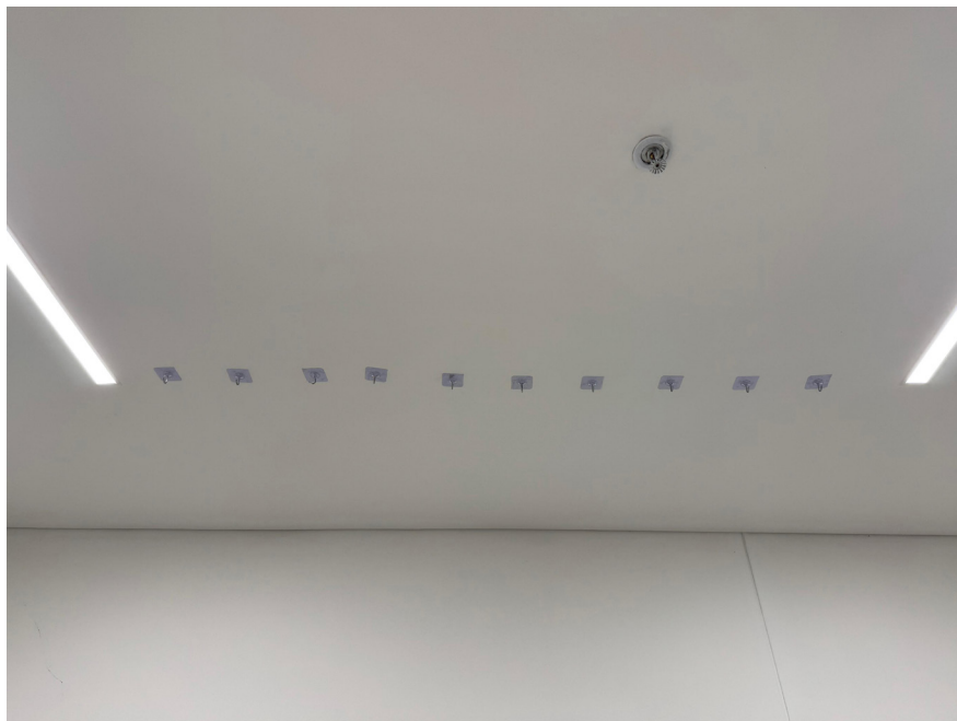
Figura 84. Ganchos instalados en el techo para soporte de tambores.
