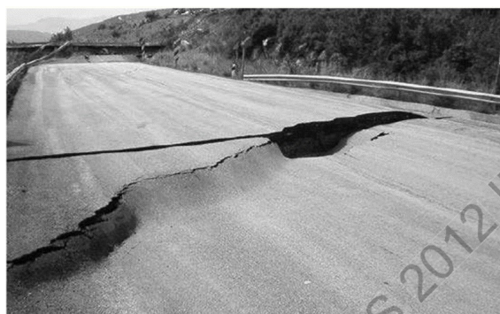
Figura 9: Movimiento de tierra rotacional
