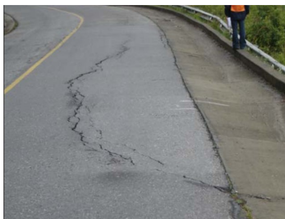
Figura 8: Fisura de medialuna
