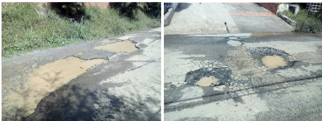
Figura 31: Baches encontrados en el tramo de la figura anterior.
