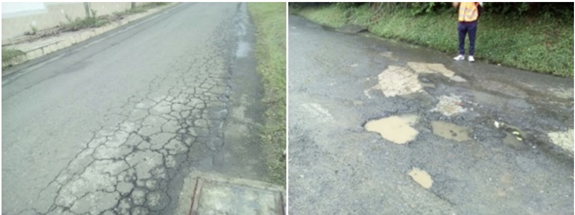
Figura 29: Deterioros encontrados en el tramo de la cra 116.
