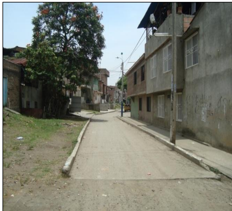
Imagen 10. Vías sin pavimentar
