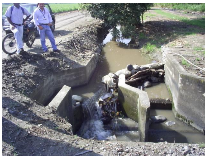
Foto 5: Obra tripartita subderivación 9-3 o Acequia Villa Gorgona
