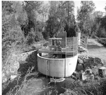
Figura 6 Embalse de la planta hidroeléctrica de vórtice en Schöftland [10].
