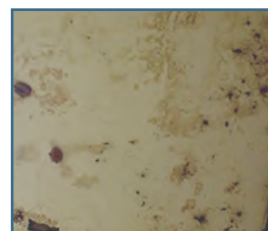
48. Fuente: Curso patología de la construcción.
