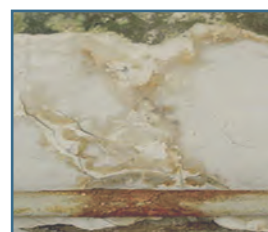
40. Fuente: Curso patología de la construcción.
