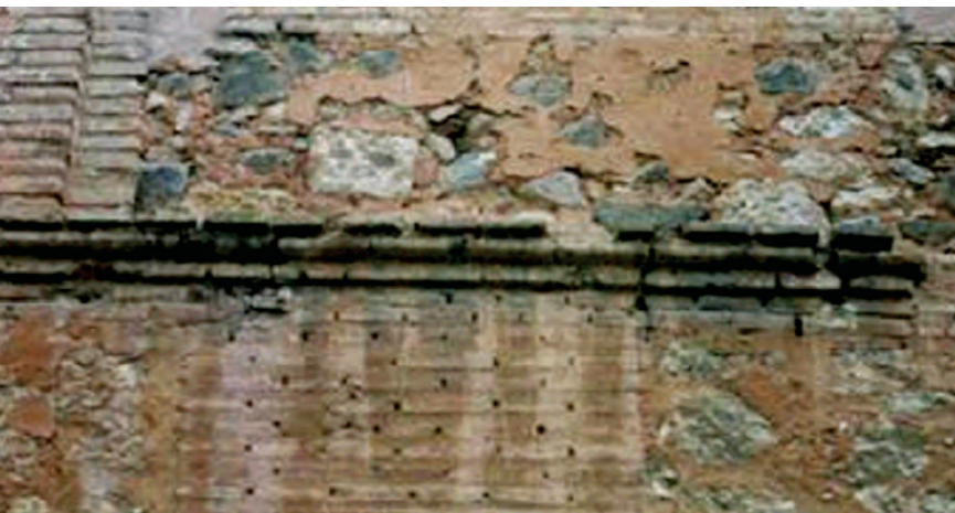
Pátina de lavado sobre ladrillo
