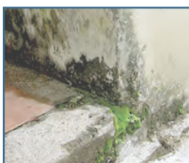
38. Fuente: Curso patología de la construcción.
