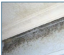
20. Fuente: Curso patología de la construcción
