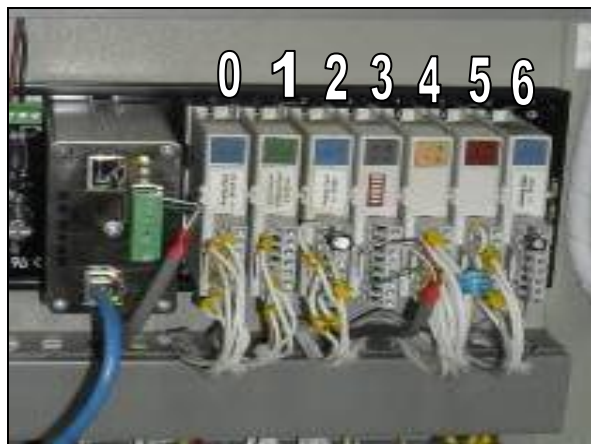
Figura 3.10 Módulos de entrada/salida del PAC.
