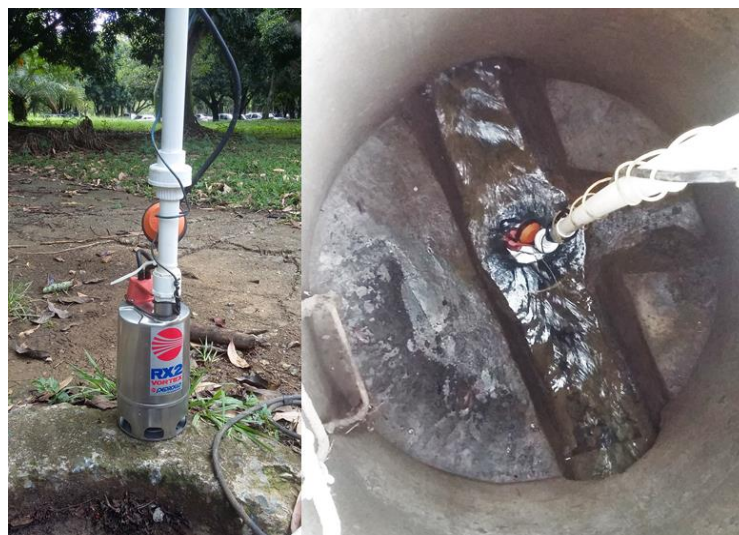
a. b. Figura 7. Sistema implementado para la extracción del agua residual. a. Electrobomba sumergible RX 2 VORTEX. b. Montaje electrobomba
