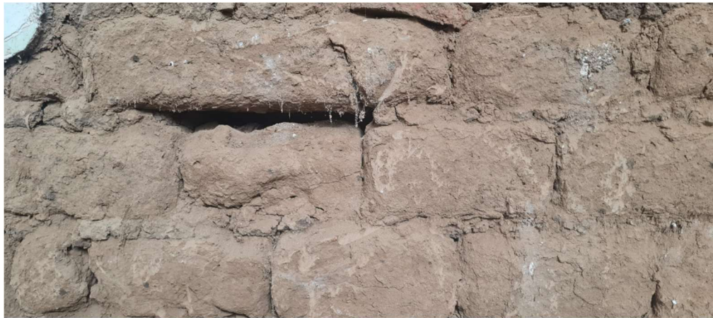
Ilustración 16. Estado de unidades de mampostería (Adobe).
