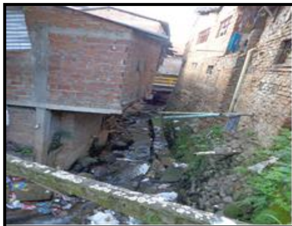
Foto 25. Como se aprecia en esta imagen es habitual que algunas viviendas depositen sus aguas residuales en lo que fueron pequeñas quebradas de aguas cristalinas. Fuente: fotografía tomada por el Tesista, 2012.
