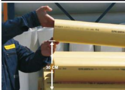
Imagen No.1: Altura máxima de caída de tubería.
