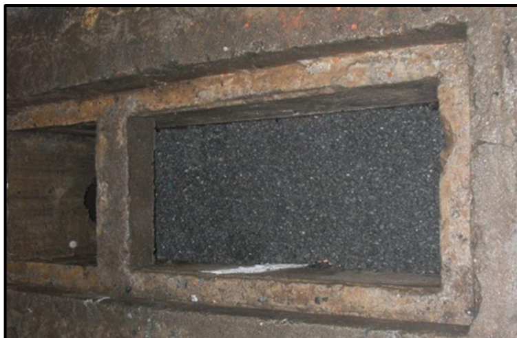
Figura A11. Modificación realizada en el Sumidero.
