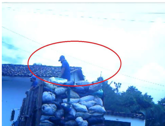
Figura 9. Operario sobre el volco de la volqueta cercano a unas cuerdas de energía del municipio.
