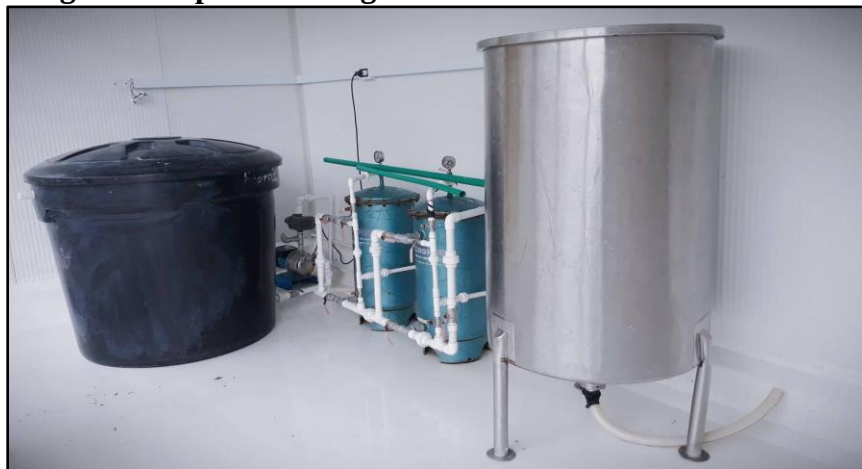
Imagen 8 Captación de agua
