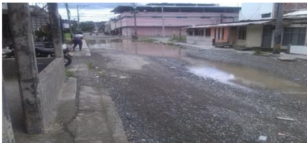
Imagen 4. Calle principal destruida por construcción de obra retenida
